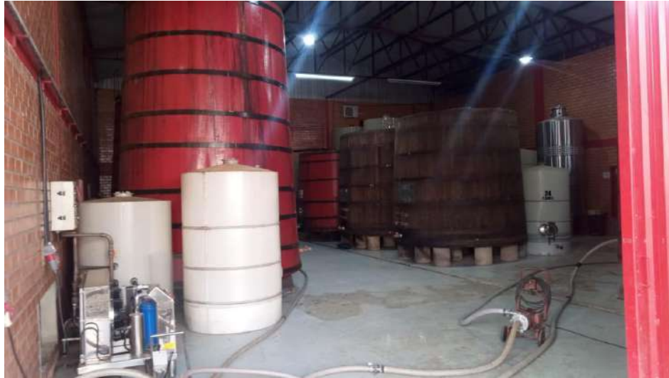
Tanques de Vinho
